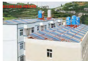
云南能源职业技术学院80吨集中供热系统
